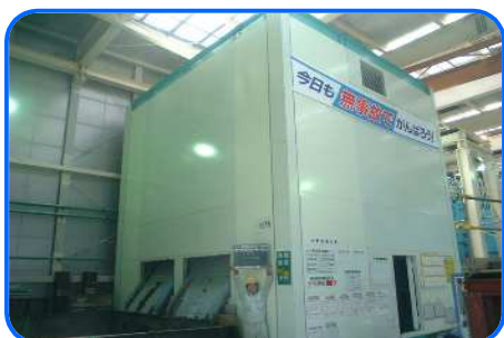
■ 泥水処理設備 (振動バルブ防音ハウス)
