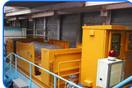
■ 泥水処理設備 (濃縮デカター)
