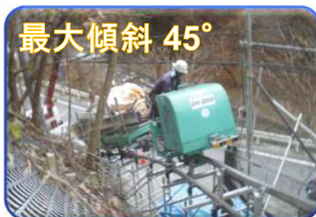
■ 工事用モノレール
